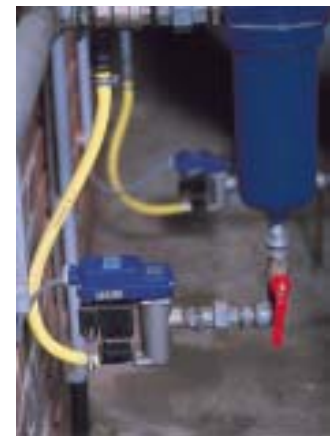
Bekomat 12 asennettuna suodattimeen
